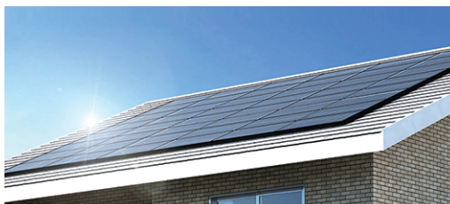
太陽光発電システム
