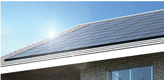
太陽光発電システム
