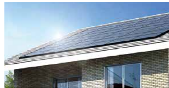
太陽光発電システム
