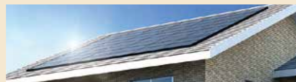
太陽光発電システム
