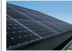
太陽光発電システム
