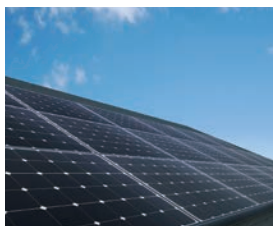
太陽光発電システム
